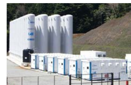
実証施設の外観
