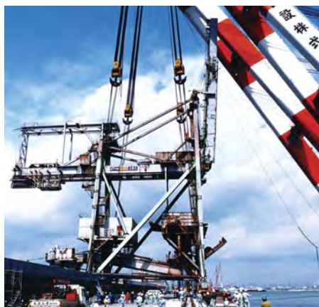
加古川製鉄所原料岸壁に設置されるアンローダー
