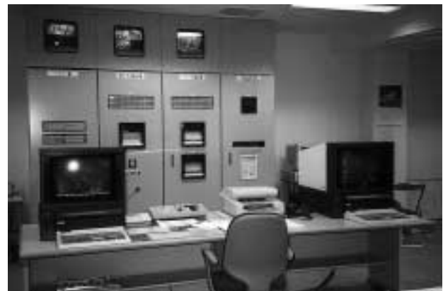
写真2 中央制御装置(DCS) Photo 2 Main control system(DCS)
