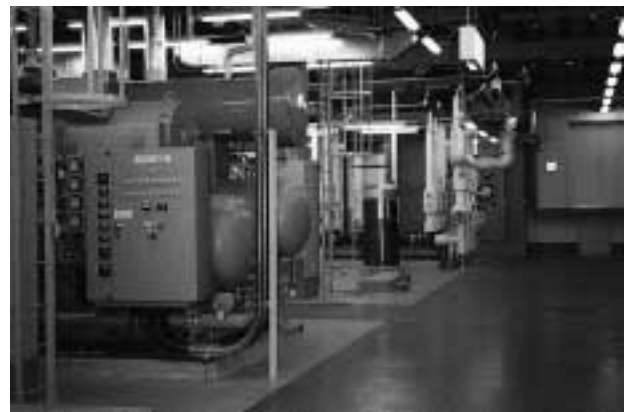
写真1 熱源機および機側制御装置 Photo 1 Heat generation / cooling equipment and local control panel
