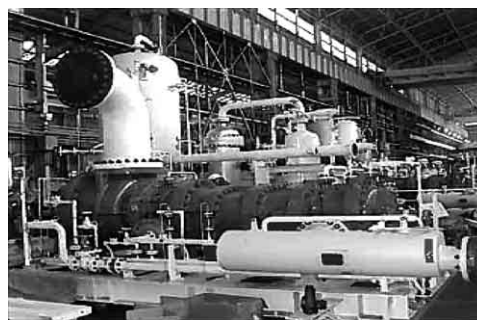
図6 水素ガス圧縮機ユニットの外観
