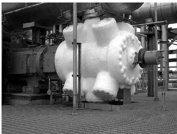
図3 LNG BOG 圧縮機 Fig. 3 LNG BOG compressor
