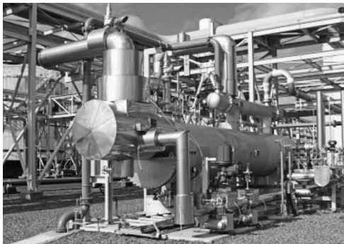
図8 空調設備へ冷熱を供給するIFVの外観（日本ガス株式会社鹿児島受入基地）
