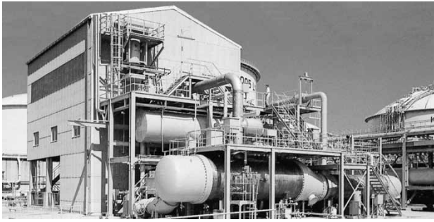
図4 大阪ガス株式会社のLNG冷熱発電プラント外観
