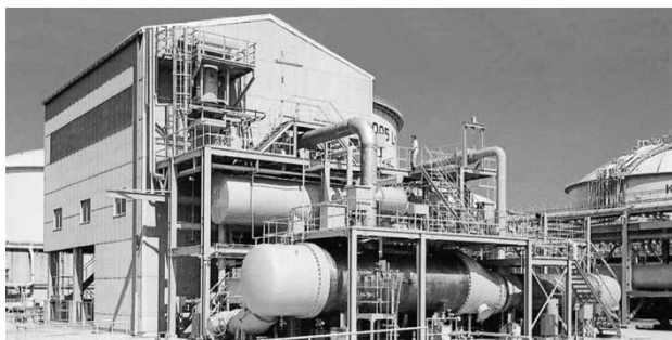
図4 大阪ガス株式会社のLNG冷熱発電プラント外観
