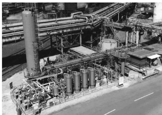
図2 加古川製鉄所に建設された当社商用第一号のCO-PSAプラント Fig.2 Commercial CO-PSA plant installed in KOBE STEEL Kakogawa works
